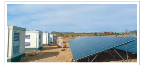
德国16.77MWh集装箱储能项目 Germany 16.77MWh Containerized Energy Storage Project
