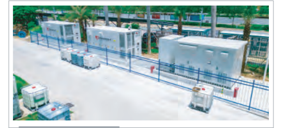
珠海鹏辉工业园29.77MWh项目 Zhuhai Great Power Production 29.77MWh Project
