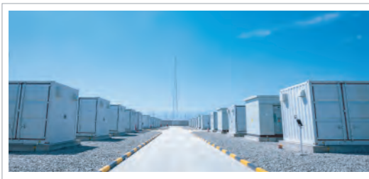
新疆吉木萨尔 150MWh光储项目 Jimusaer 150MWh Project
